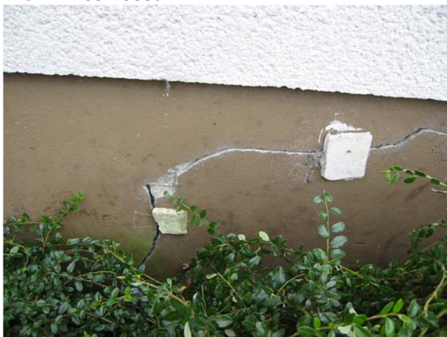
Bild 3: vom Untergrund abgelöste Gipsmarke
